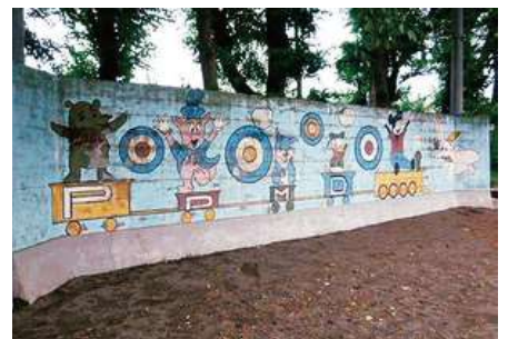
写真は、危険が指摘された上溝南小学校のブロック塀
